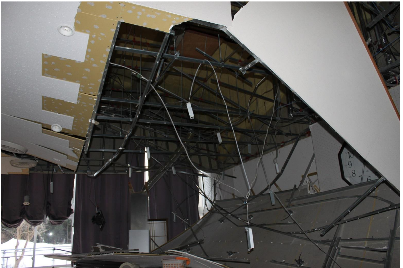
崩落した天井
