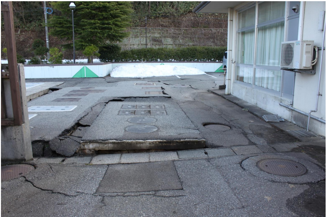
汚水処理施設
